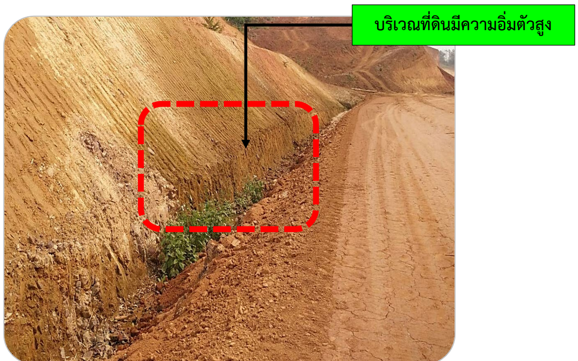
รูปที่ ๑๐ ลาดดินตัดที่ดินมีสภาพอึดตัว บริเวณ กม.๑๐+๖๐๐.๐๐๐
