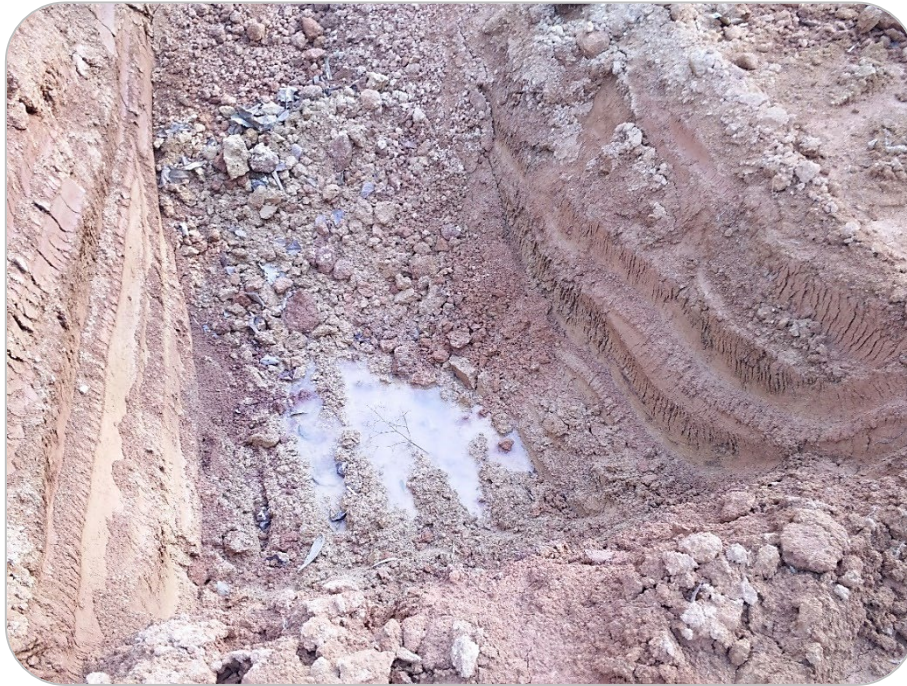
รูปที่ ๑๑ บ่อสังเกตระดับน้ำใต้ดิน กม.๑๐+๔๐๐.๐๐๐
