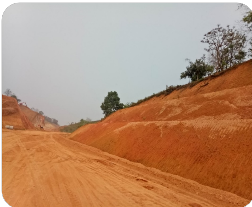
รูปที่ ๓ บริเวณที่พบการอ่อนตัวหลังการบดอัดดินฐานราก บริเวณ กม. ๑๐+๔๐๐.๐๐๐
