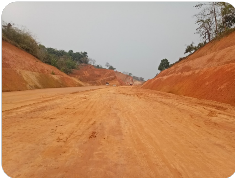
รูปที่ ๔ บริเวณที่พบการอ่อนตัวหลังการบดอัดดินฐานราก บริเวณ กม. ๑๐+๔๕๐.๐๐๐
